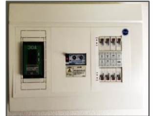
※1 写真イメージ (分電盤全体が写る写真)
